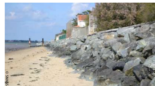
Ouvrage de protection actuel à Ronce-les-Bains, La Tremblade
